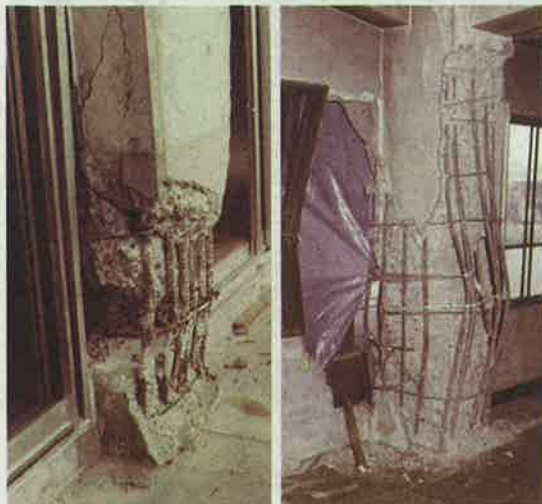
◀柱の被害の様子。帯筋の間隔が開いているためにコンクリートがせん断破壊していたり、主筋(縦方向に伸びる太い鉄筋)が折れ曲がっている。左写真は75年の大分県中部地震、右写真は78年の宮城県沖地震(写真提供=琉球大学工学部教授・森下陽一氏)
